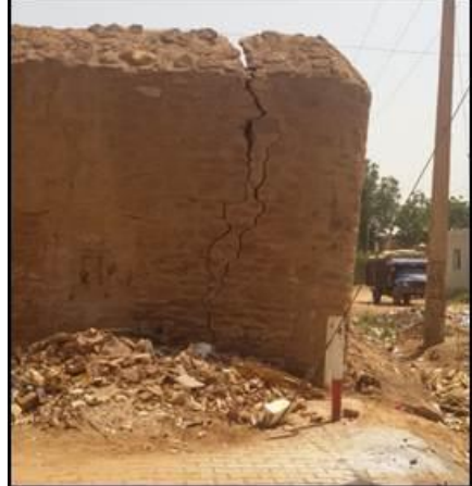
لوحة رقم ٥٧ النهاية الجنوبية للسور الغربي لدار الرياضة، ويظهر بها شرخ كبير. تصوير الباحثة.
